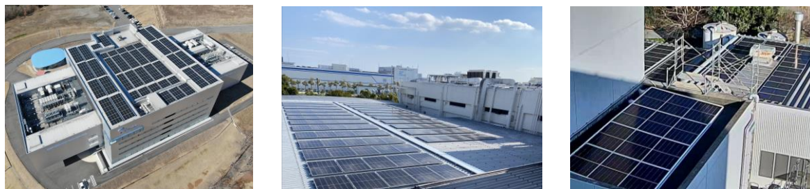
各工場に新たに設置した太陽光発電設備(左から 徳島美馬工場、徳島工場、高崎工場)
