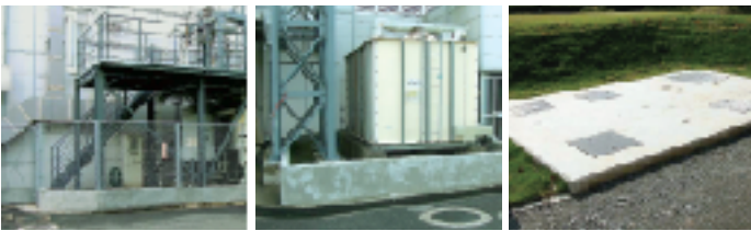
冷媒回収エリアの防液堤 屋外冷媒タンクの防液堤 雨水マスおよび自動遮断弁
