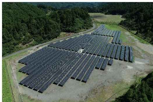
当社敷地内に設置した太陽光発電設備
