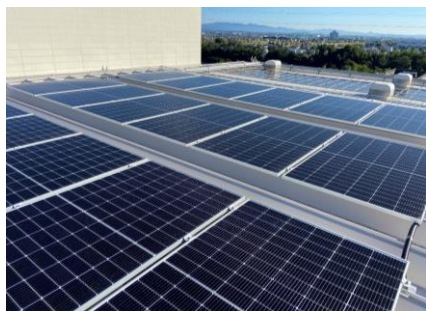
高崎工場に設置した太陽光発電設備
